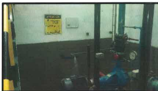
Imagen N°4: Salida Planta Potabilizadora
